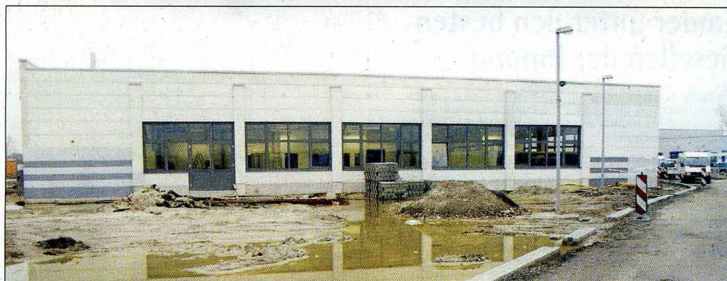
Der 1. Bauabschnitt: Die Betriebshalle für die Metallverarbeitung (Vorderansicht aus Blickrichtung Herderstraße) ist fertiggestellt. Bild: RB
